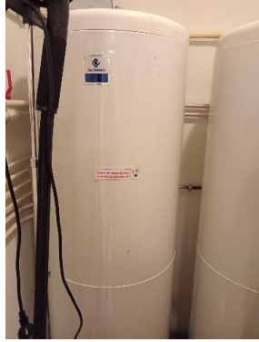
Ballon ECS De dietrich - Sous-sol
